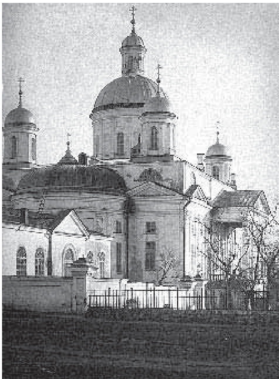
Аварийное состояние, 1920-е гг.
